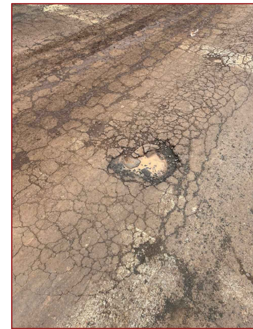
Trecho que a via apresenta irregularidade na superfície. Será realizada fresagem do trecho irregular.
