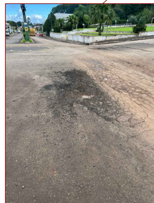
Trecho que a via apresenta irregularidade na superfície. Será realizada fresagem do trecho irregular.
