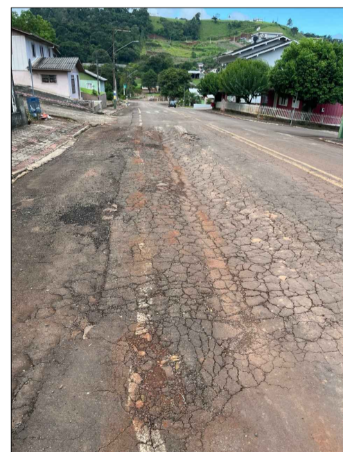
Trecho que a via apresenta irregularidade na superfície. Será realizada fresagem do trecho irregular.
