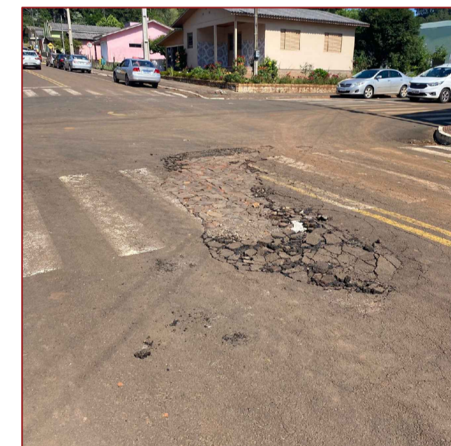
Trecho que a via apresenta irregularidade na superfície. Será realizada fresagem do trecho irregular.
