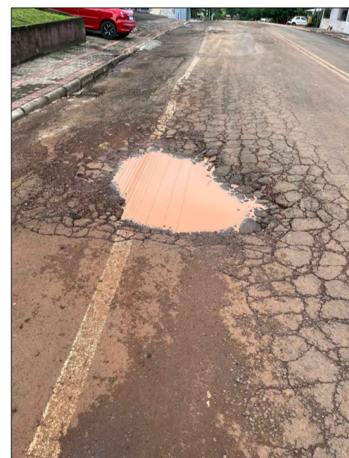
Trecho que a via apresenta irregularidade na superfície. Será realizada fresagem do trecho irregular.
